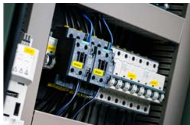
Přístup do rozvaděče, který je snadný pro údržbu.
